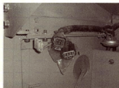
（写真9）不要パーツ撤去後の不要コネクター
